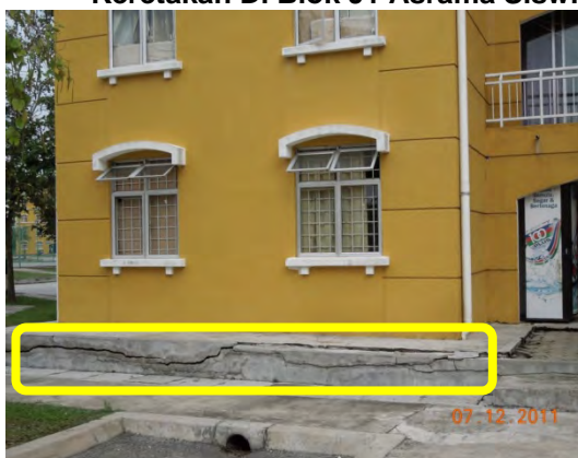
Gambar 10.1 Keretakan Di Blok J1 Asrama Siswi
