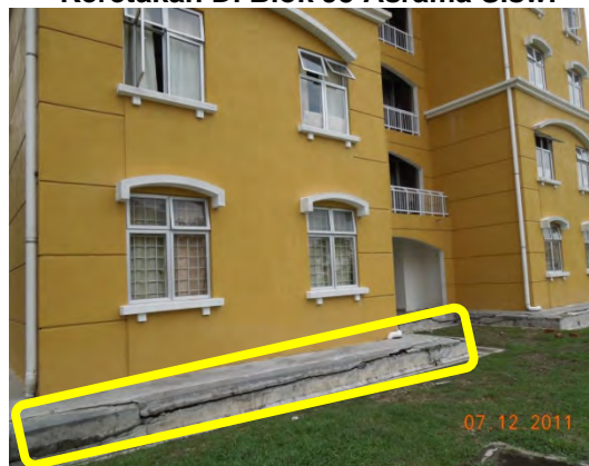
Gambar 10.4 Keretakan Di Blok J5 Asrama Siswi
