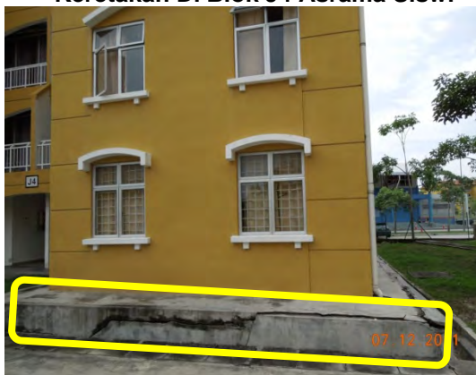
Gambar 10.3 Keretakan Di Blok J4 Asrama Siswi
