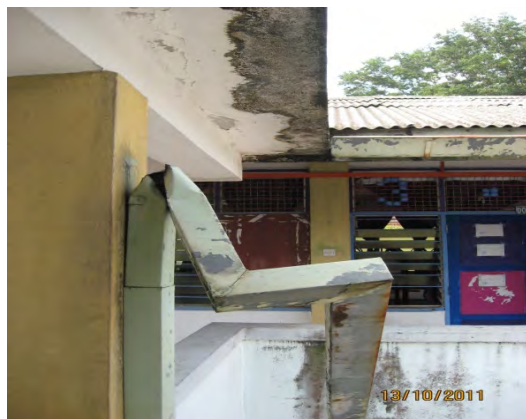
Gambar 4.17 Gutter Air Yang Telah Rosak
