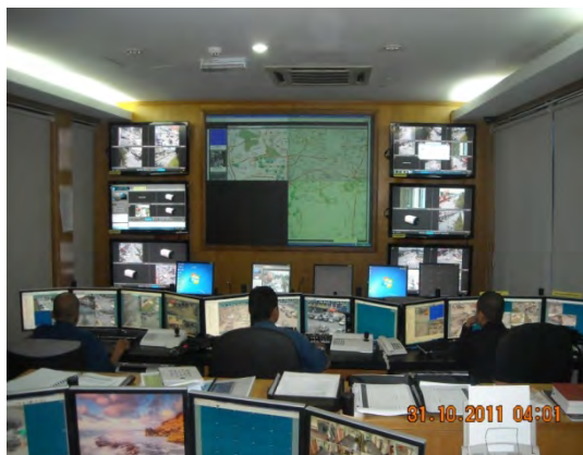
Gambar 7.1 Pemantauan Terhadap Imej CCTV Sedang Dijalankan
