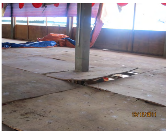
Gambar 5.5 Lantai Reban Reput Dan Tercabut Daripada Gelegar Lantai
